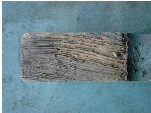
圖 10. 腳座與地面接觸的地方腐朽（攝影／王督宜）
