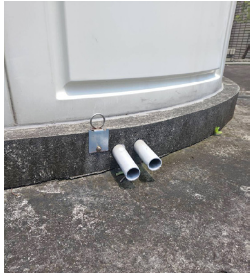
圖 2. 天文臺圓頂的基座部分，白色部分為圓頂主結構，而底下的水泥臺乃額外施作，能保護博物館本體樓板的結構，且能預留排水和弱電管線空間，而基座上的金屬環為防風環扣，當有颱風時可以扣上防護網保護圓頂葉片不被強風破壞及吹落。（攝影／王斌威）
