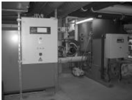
圖8. 天然氣壓縮鍋爐(左)及吸收熱泵(右)
