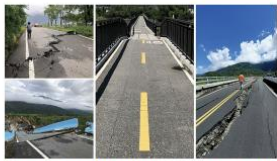
圖1 池上地震的橋樑破壞。左上圖：崙天大橋東側路面受擠壓突出的地表變形；左下圖：正在拆除的崙天大橋；中圖：玉里舊鐵橋的板塊交界紀念碑，在池上地震過後兩側的高差增加到快半公尺左右，還有少量的斷層左移現象；右圖：被地震破壞的高架大橋橋面。
