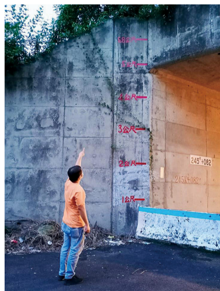
圖2 在高速公路涵洞旁水泥牆面上清楚的看到李振儀理事長用紅漆標示的桃芝颱風淹水線(離路面高5.8公尺)，桃芝颱風的淹水線幾乎快淹到國道三號高速公路的路面。
