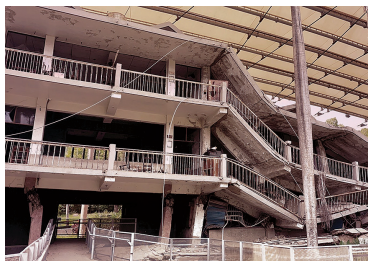
圖8 倒塌建築：臺中光復國中北棟毀損教室
