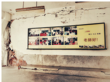
圖4 倒塌建築：臺中光復國中南棟教室
