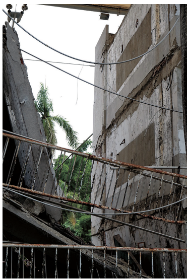
圖2 分期興建導致新舊結構不連續
