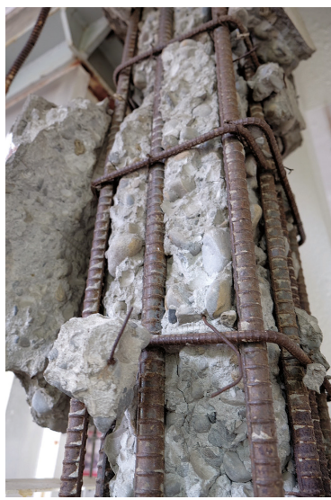
圖1 柱子箍筋間距過寬、缺少耐震彎鉤
