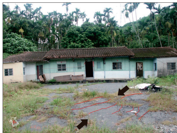
圖6 集集地震引致的地表破裂遺跡。竹山槽溝東邊約30米處的三合院，其庭院的柏油出現一系列方向性的地裂縫(部分以紅線示意於照片中)，為斷層引致的擠壓效應所造成，雜草沿部分裂縫生長。黑色箭頭指示壓應力的方向。
