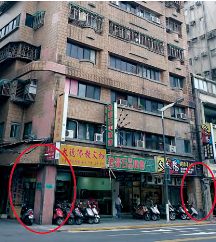
圖3 典型的軟底層建築(一樓騎樓外僅兩根柱子支撐的十層樓房)
