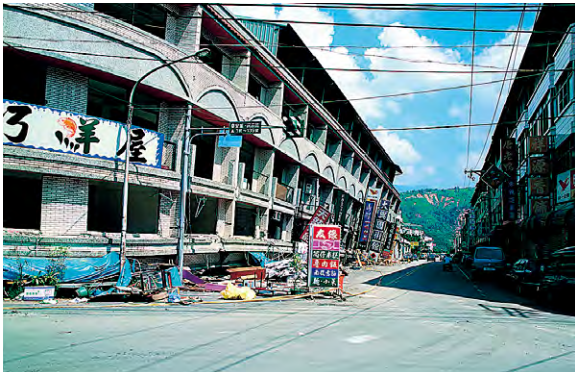
圖1 集集地震造成昔日南投縣埔里鎮聯合市場一樓壓垮情形(照片提供：經濟部中央地質調查所)
