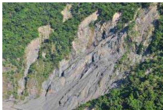
圖 14. 金崙鄉地克崙（都老老恩溪口）金崙溪河段屬潮州層大武段變質砂頁岩互層地層，岩性軟弱不堅硬，易風化崩塌。
