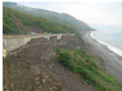
圖 27. 臺 9 線南迴公路大鳥溪口至大鳥橋間屬潮州層砂頁岩互層地層，岩性軟弱，又為順向坡，常有邊坡滑移，目前仍搶修中。
