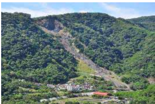
圖 26. 大竹溪流域大武鄉愛國埔聚落，背後山坡屬潮州層大武段砂頁岩互層地層，岩性軟弱易風化，山崩土石流嚴重，每逢颱風豪雨常造成威脅。
